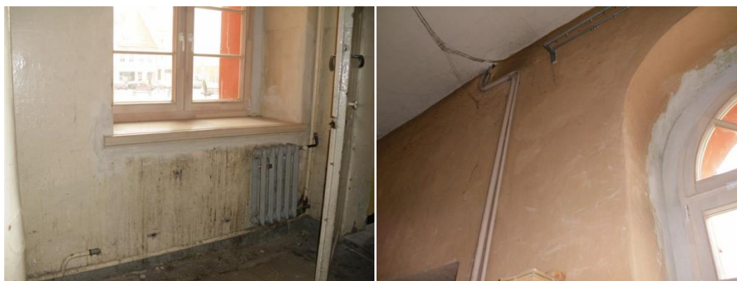
Zdjęcie 2. Pomieszczenia Ratusza wymagające rewitalizacji – stan techniczny [Źródło: Urząd Miejski w Grodkowie]
